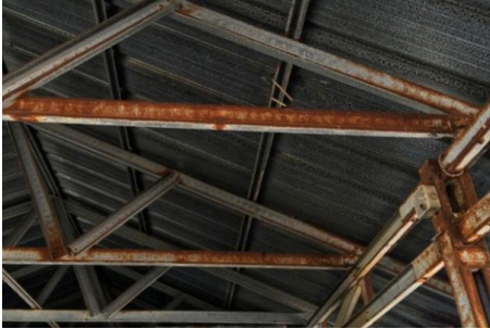
النتيجة: صدأ في كل حفرة، مطلي فوقه
