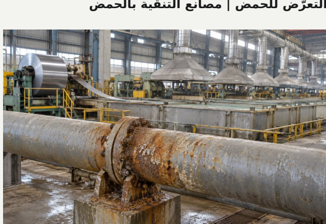
أبخرة وترشحات الحمض. أسطح الأنابيب الخارجية تتآكل.
