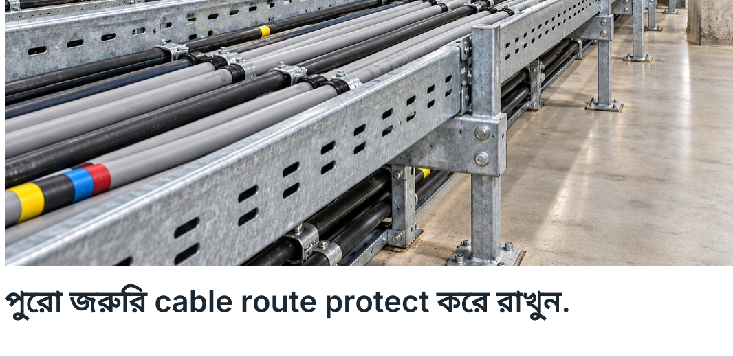
পুরো জরুরি cable route protect করে রাখুন.
