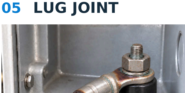
BEFORE: তাপে নষ্ট JOINT
