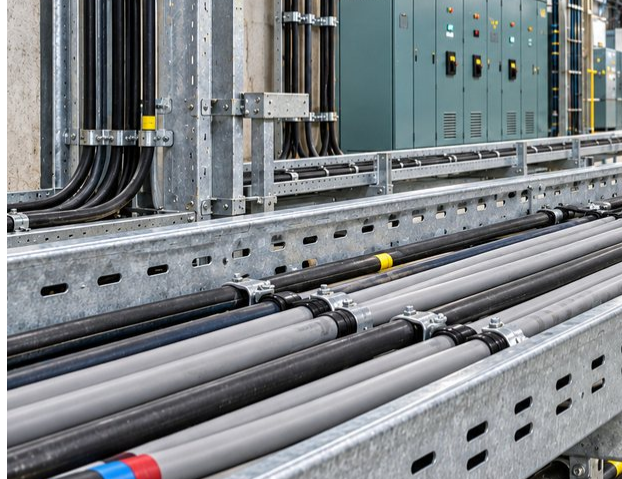
EC 43 General · Kabeltrassen
