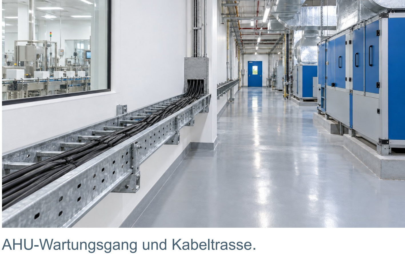
AHU-Wartungsgang und Kabeltrasse.
