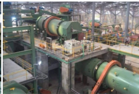
Salzhaltige Luft — Stahl am Prillturm
