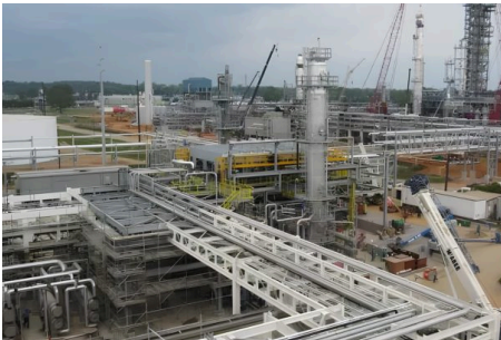
Verrosteter Stahl an laufender Anlage — Strahlen unmöglich
