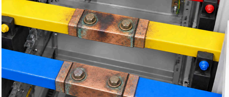
VORHER: KORRODIERTER STOß
