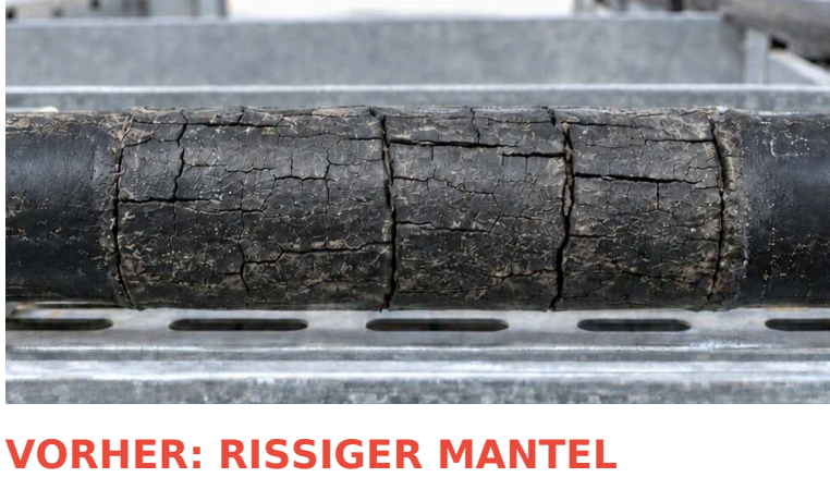
VORHER: RISSIGER MANTEL
