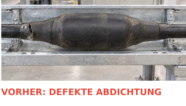
VORHER: DEFEKTE ABDICHTUNG
