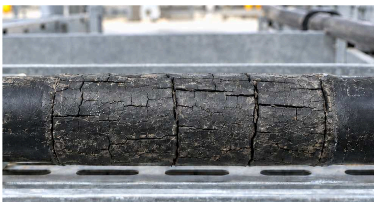
ANTES: CUBIERTA AGRIETADA
