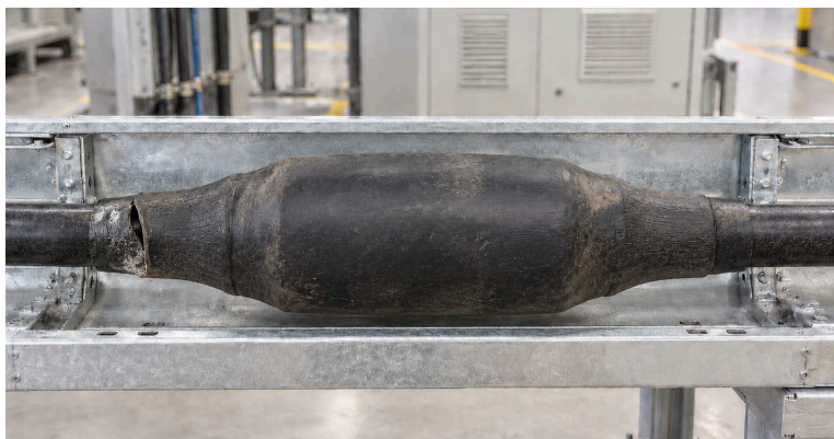
ANTES: SELLO DAÑADO
