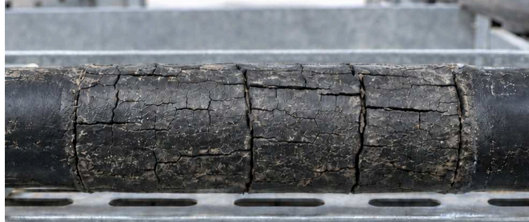
AVANT : GAINÉ FISSURÉE
