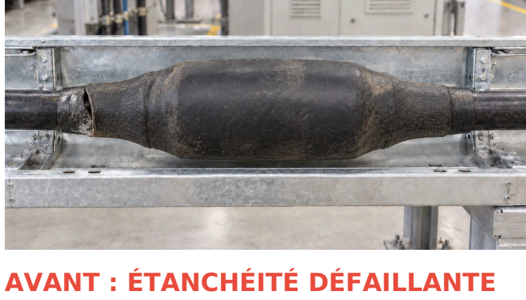
AVANT : ÉTANCHÉITÉ DÉFAILLANTE
