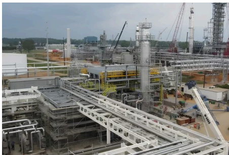
जंग लगा लाइव-यूनिट स्टील — ब्लास्टिंग नामुमकिन
