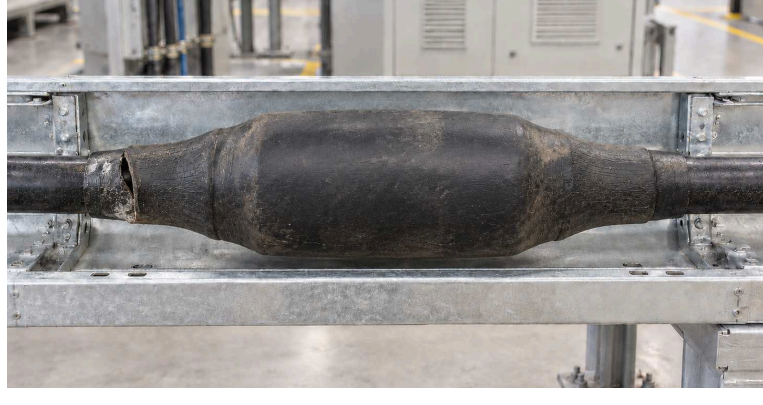
पहले: JOINT SEAL खराब
