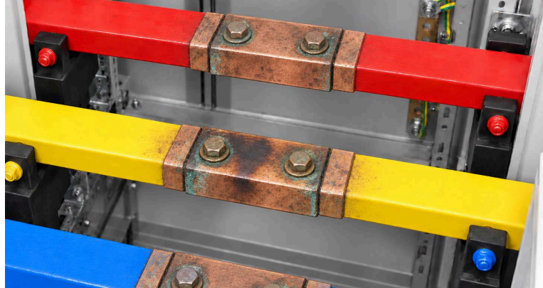
पहले: SPLICE में CORROSION
