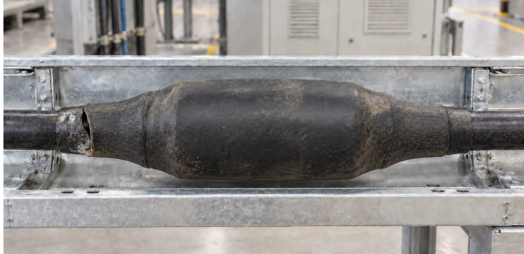
SEBELUM: SEGEL SAMBUNGAN RUSAK
