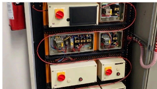
ガス消火設備
