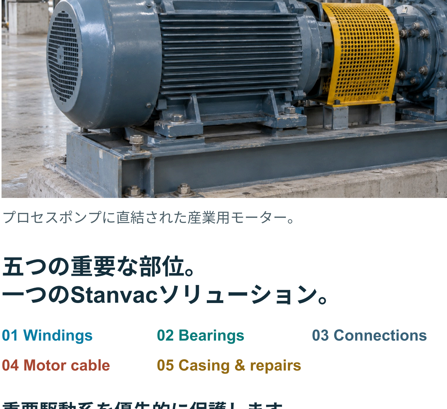
プロセスポンプに直結された産業用モーター。
