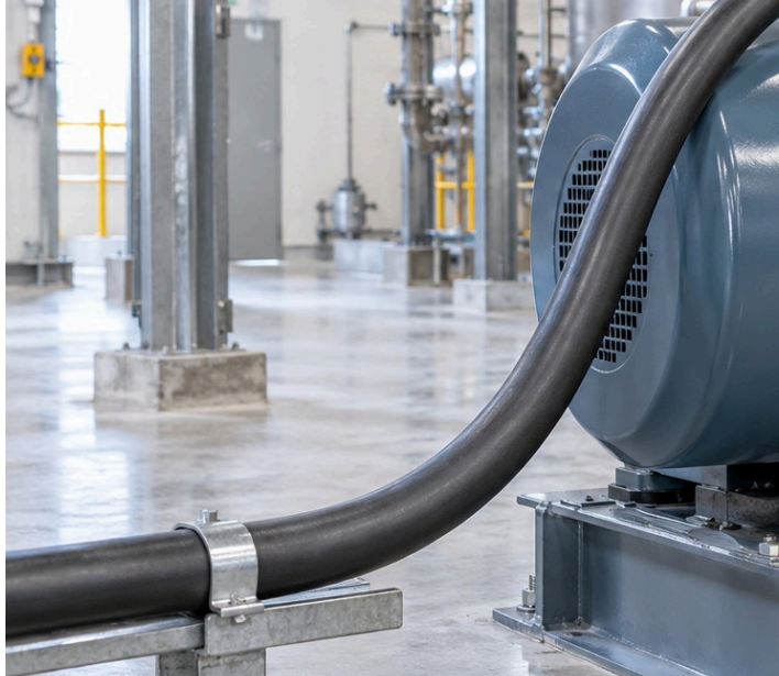
モーター端子接続部。
