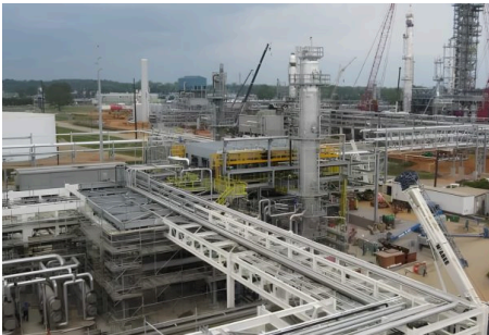
稼働中ユニットの錆びた鋼材—ブラスト処理は不可能
