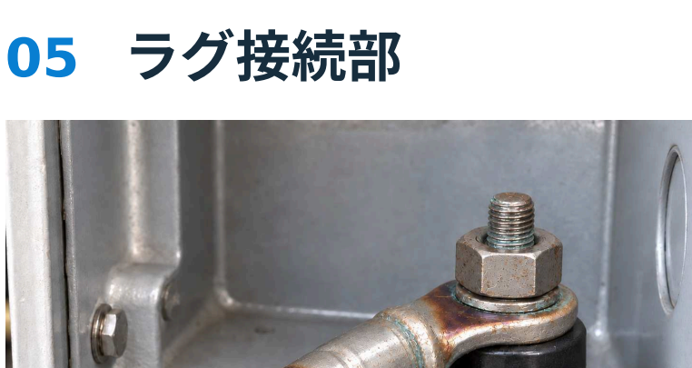
施工前：熱損傷した接続部
