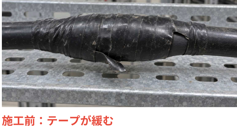
施工前：テープが緩む
