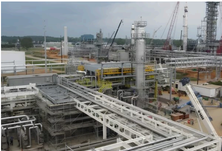
가동 중인 설비의 녹슨 강철 — 블라스팅 불가능
