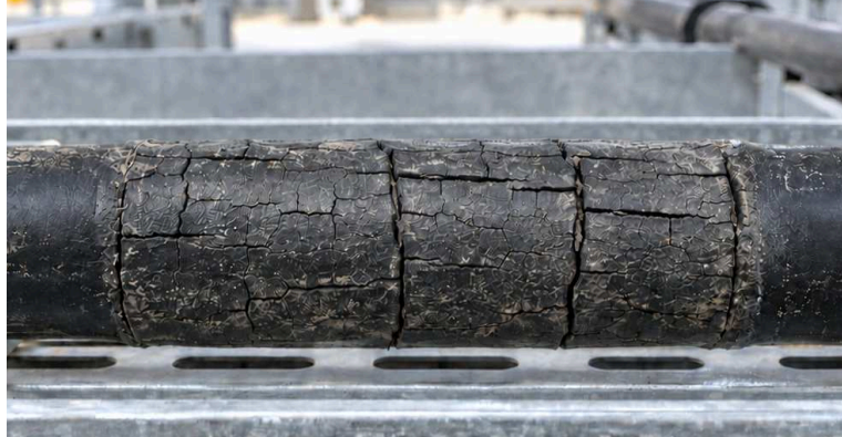
시공 전: 갈라진 외피
