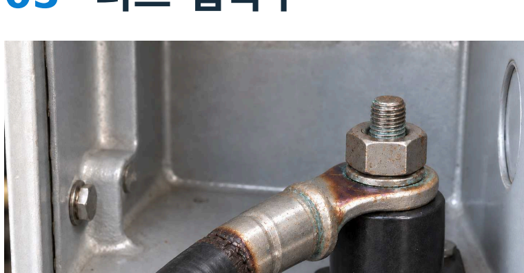
시공 전: 열 손상 접속부
