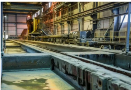
ആസിഡ് പുക ആക്രമണം — പിക്കിളിംഗ് ഷെഡ്
