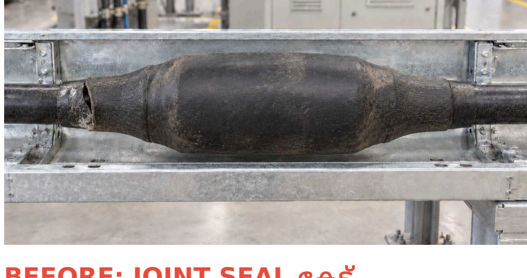
BEFORE: JOINT SEAL കേട്
