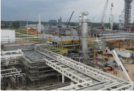
गंजलेले लाइव्ह-युनिट स्टील — ब्लास्टिंग अशक्य
