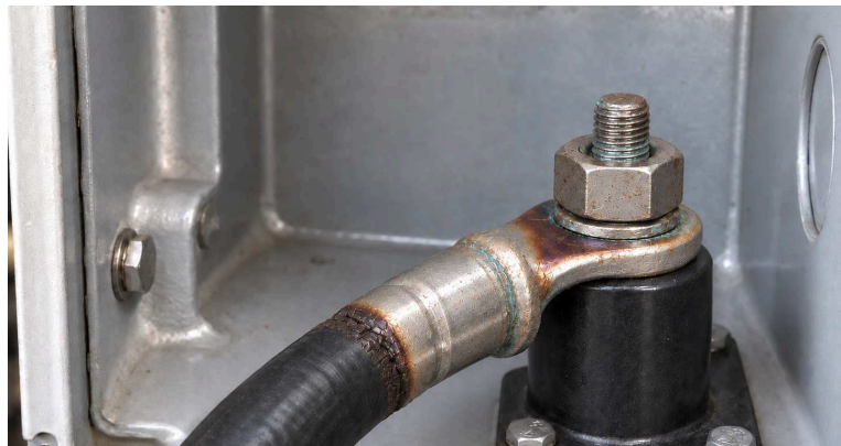
आधी: उष्णतेने खराब JOINT
