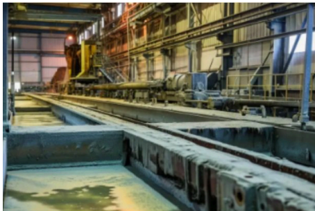
Ataque de vapores ácidos — galpão de decapagem
