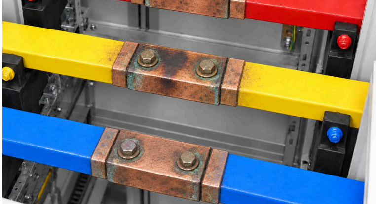
ANTES: EMENDA CORROÍDA
