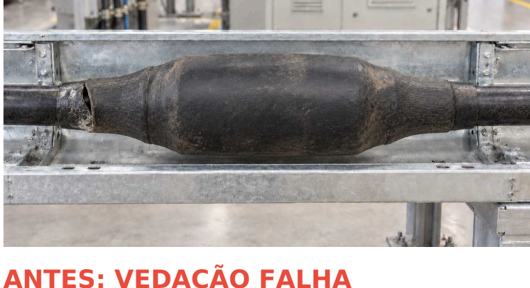
ANTES: VEDAÇÃO FALHA
