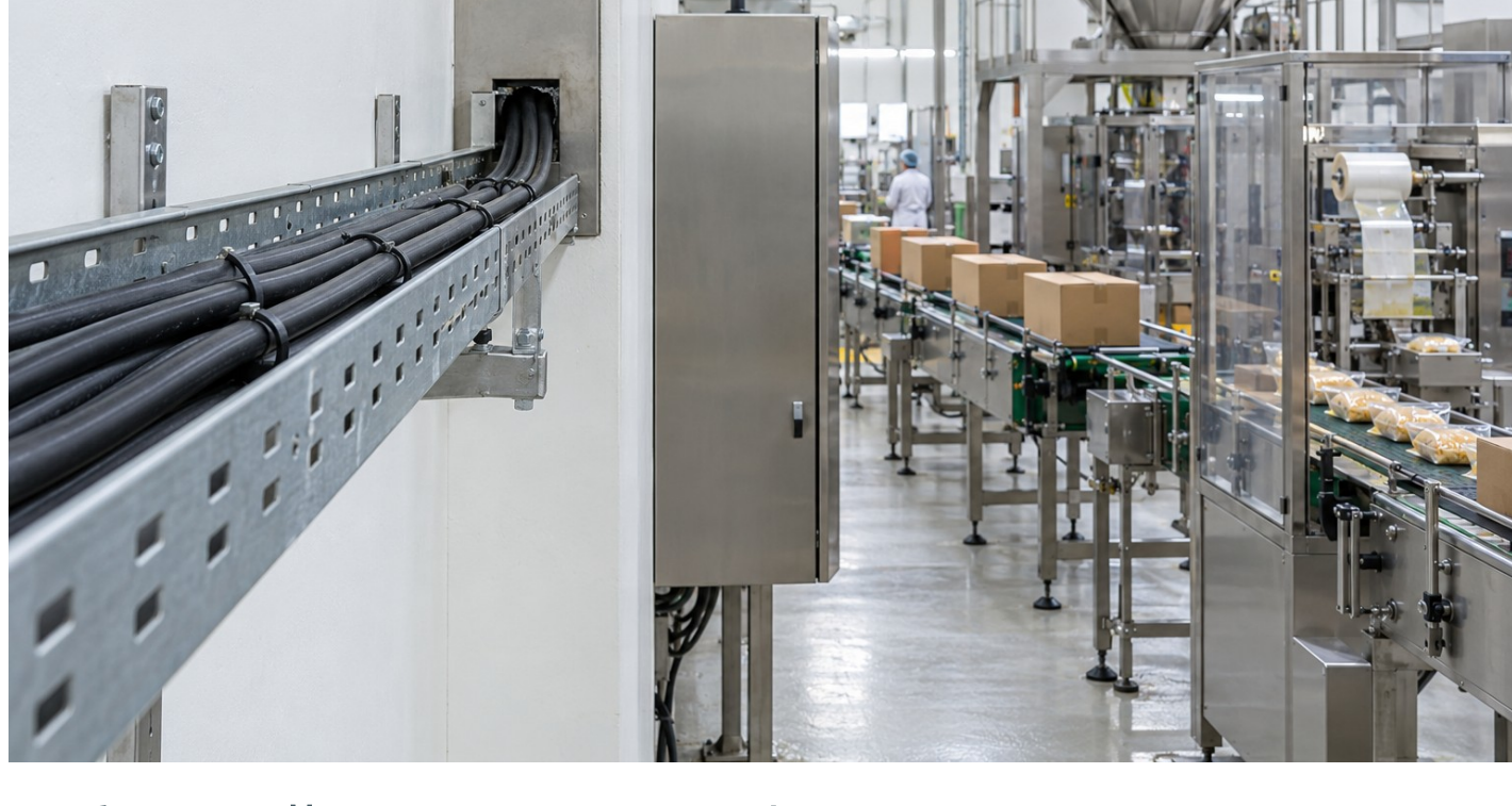
Кабельный ввод на линии фасовки.
