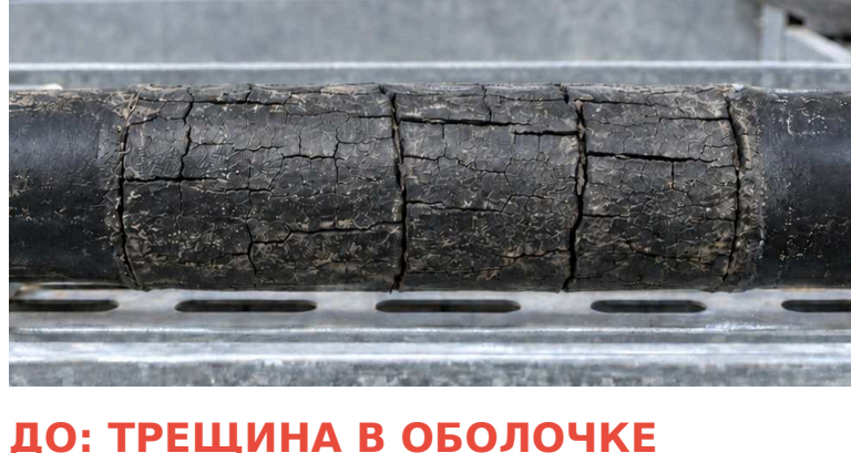
ДО: ТРЕЩИНА В ОБОЛОЧКЕ
