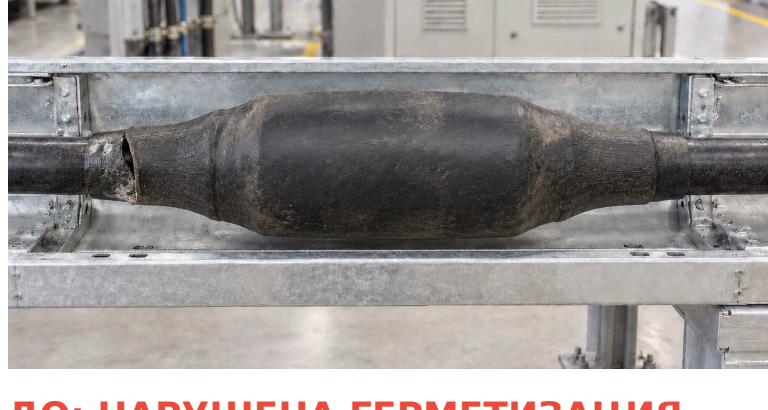
ДО: НАРУШЕНА ГЕРМЕТИЗАЦИЯ
