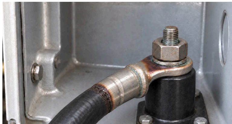
ДО: ПОВРЕЖДЕНИЕ ОТ НАГРЕВА
