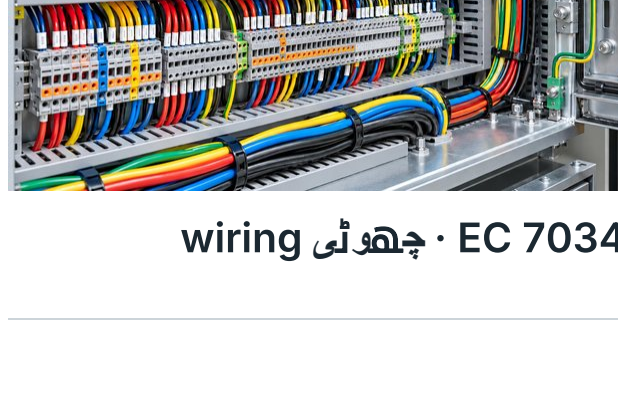
EC 7034 · چھوٹی wiring
