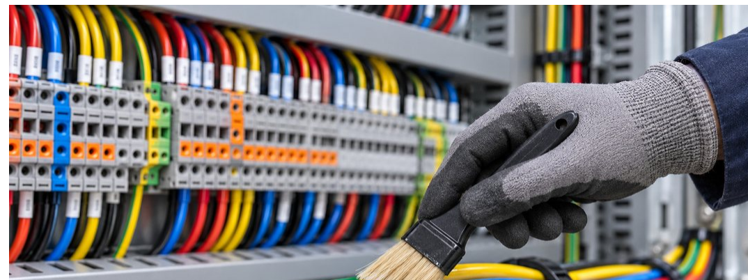
Insulation کی حفاظت کریں۔ Cable کے رنگ نمایاں رکھیں۔
