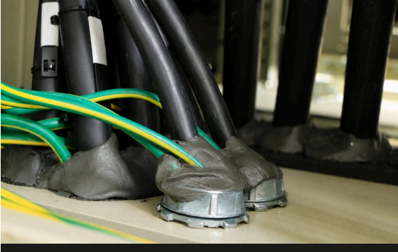
封堵电缆入口。 限制空气（氧气）进入。 阻隔火与烟。
