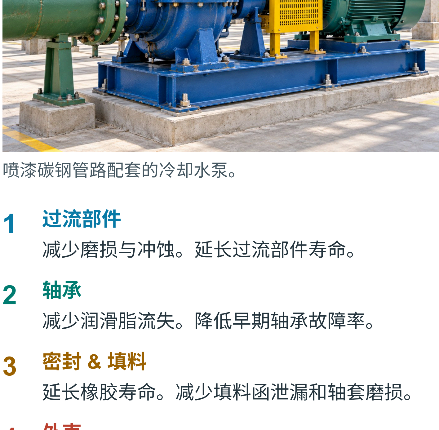
喷漆碳钢管路配套的冷却水泵。
