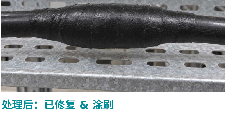
处理后：已修复 & 涂刷
