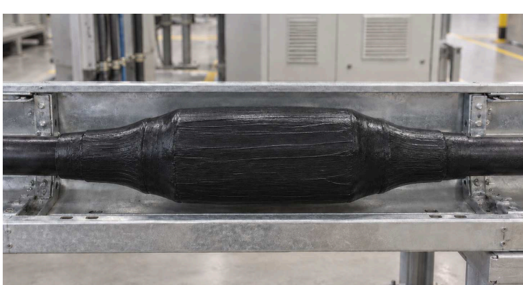
处理后：已修复 & 涂刷
